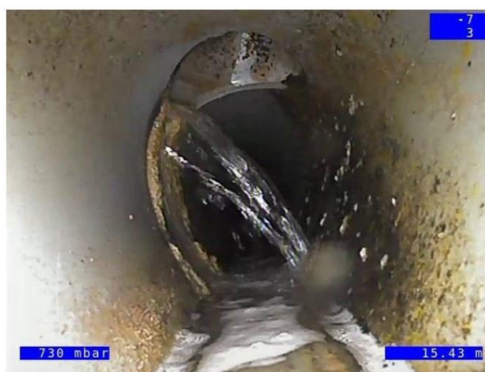
下水道管渠内カメラ調査による 不明水の状況
